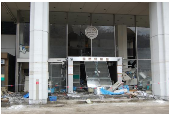
津波で損壊した宮古市役所。
