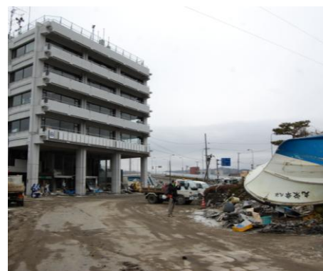
宮古市役所。1、2階が損壊。停電中でオンラインもストップ。敷地には船が転がっている。
